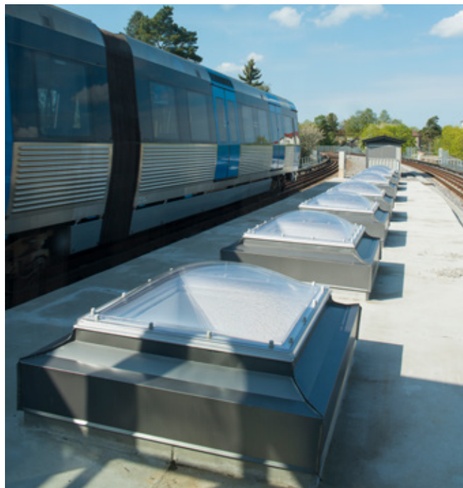
Slagtåliga kupoler med polykarbonat i alla skikt. Projekt: Stureby Tunnelbanestation, Stockholm. Arkitekt: Aperto Arkitekter.
